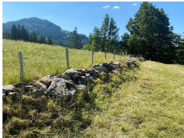
Die Trockenmauer auf der Alp ist in einem schlechten Zustand und wird voraussichtlich im Jahr 2025 saniert werden.
